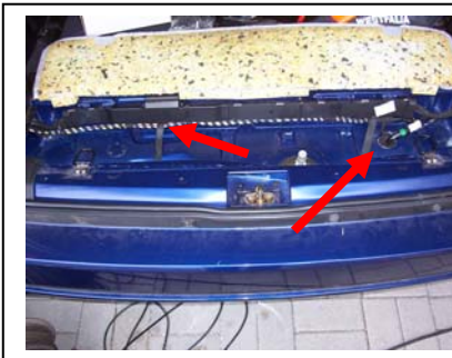
Kabelbaum AHK und Plus- kabel unter Bodenverklei- dung verlegen (Kabeldurch- führung rechts sichtbar)
